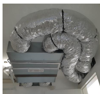
Collier aéraulique - Vue en situation
