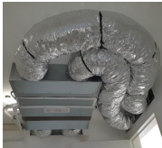
Collier aéraulique - vue en situation
