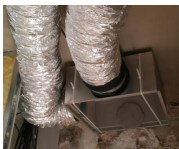
Collier aéraulique - vue en situation
