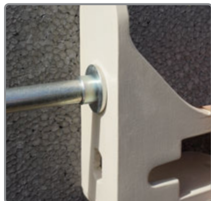
La rondelle d'appui est en place derrière le support pour éviter l'écrasement.
