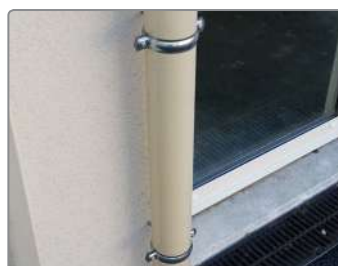
Collier descente eaux pluviales
