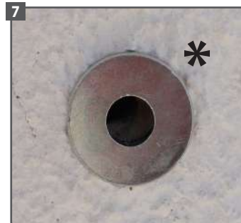
Une fois l'isolation finie, n'oubliez pas la rondelle d'appui pour éviter l'écrasement de l'isolant
